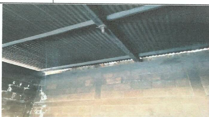
Foto 2: Remozamiento de Cocina Escolar: la cual se encuentra actualmente en este estado que además de lo anterior incluye: Colocación de azulejo en el área en donde se construirá el polletón y
