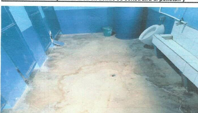
Foto 4: Remozamiento de los Servicios Sanitarios: Estado en que se encuentra actualmente el área interna de los servicios sanitarios, además de lo anterior se incluye la pintura completa tanto dentro como fuera de
